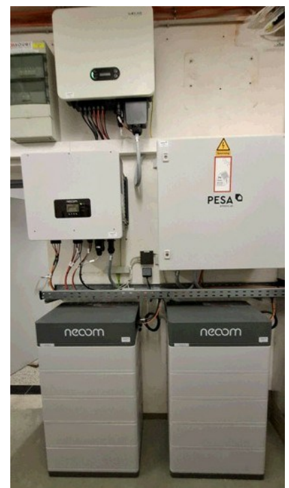
Bild: Stromspeicher in der MS Hofkirchen
